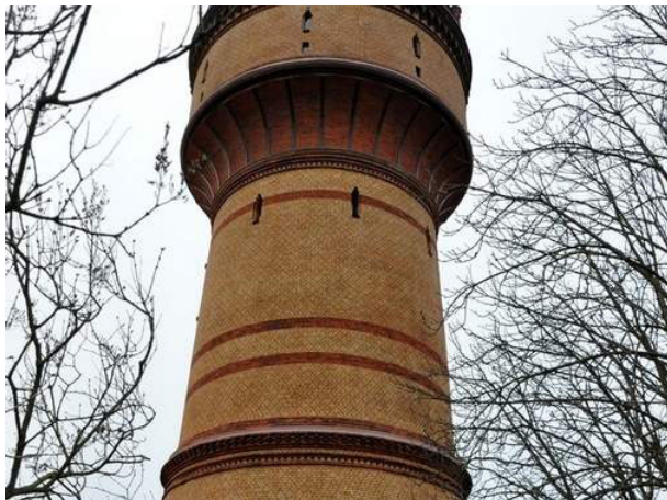
Nach der Sanierung strahlen die Klinker des Wasserturms wieder in hellem Gelb. Foto: Daniela Apel
