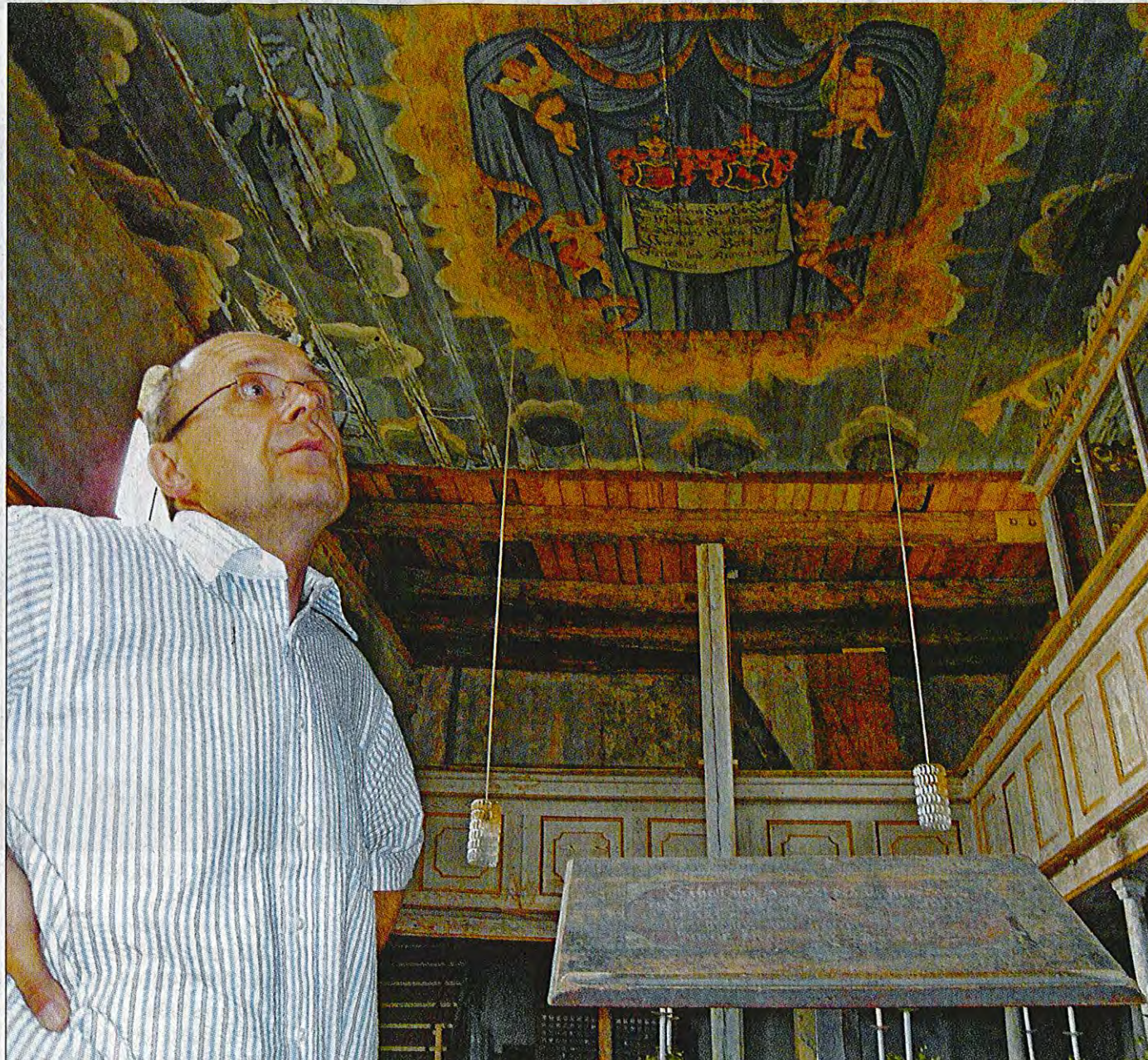
Pfarrer Georg Strutz betrachtet die sanierungsbedürftige Decke der Isterbieser Kirche.
