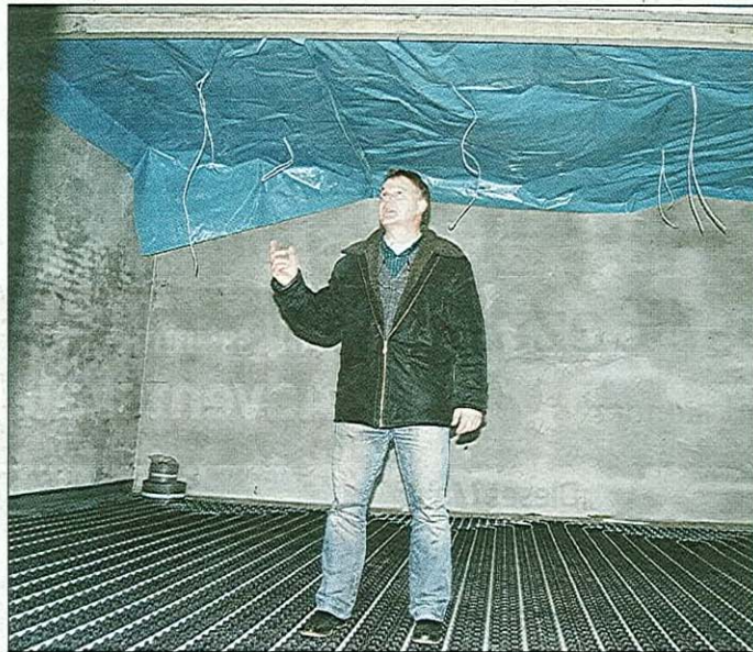
Ulrich Weimeister steht in dem künftigen Seminarraum, der eine Fußbodenheizung erhält, mit einer Lehrküche ausgestattet wird und behindertengerecht ist. Fotos (2): Daniela Apel
